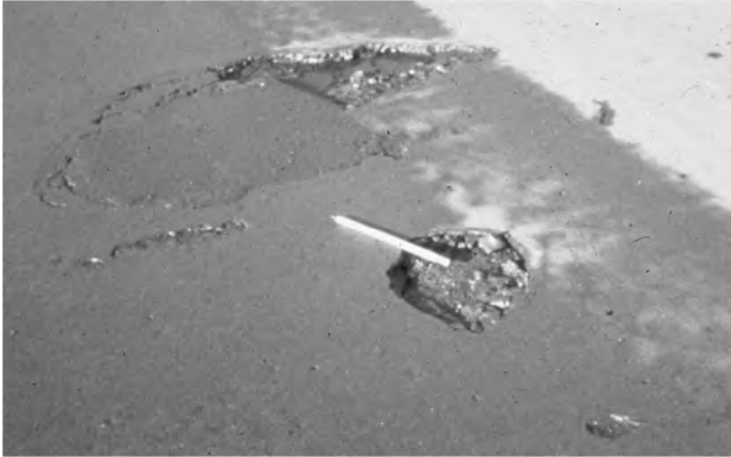
รูปที่ 4-9 แสดงการหลุดล่อนของคอนกรีต
