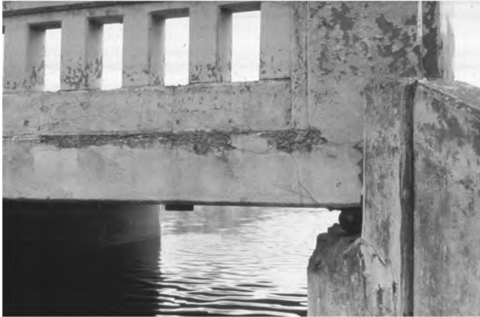
รูปที่ 4-25 แสดงรอยแตกร้าวในแนวทแยงใกล้กับปลายสะพานพื้น
