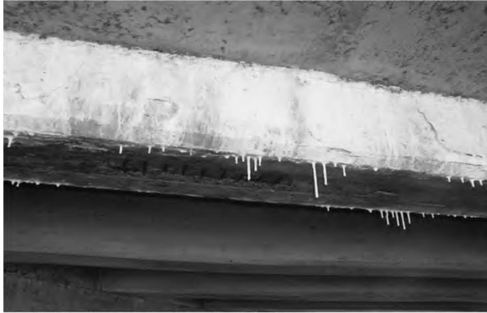
รูปที่ 4-10 แสดงการเกิดซึ่เกลือหรือคราบสีขาวบนผิวคอนกรีต
