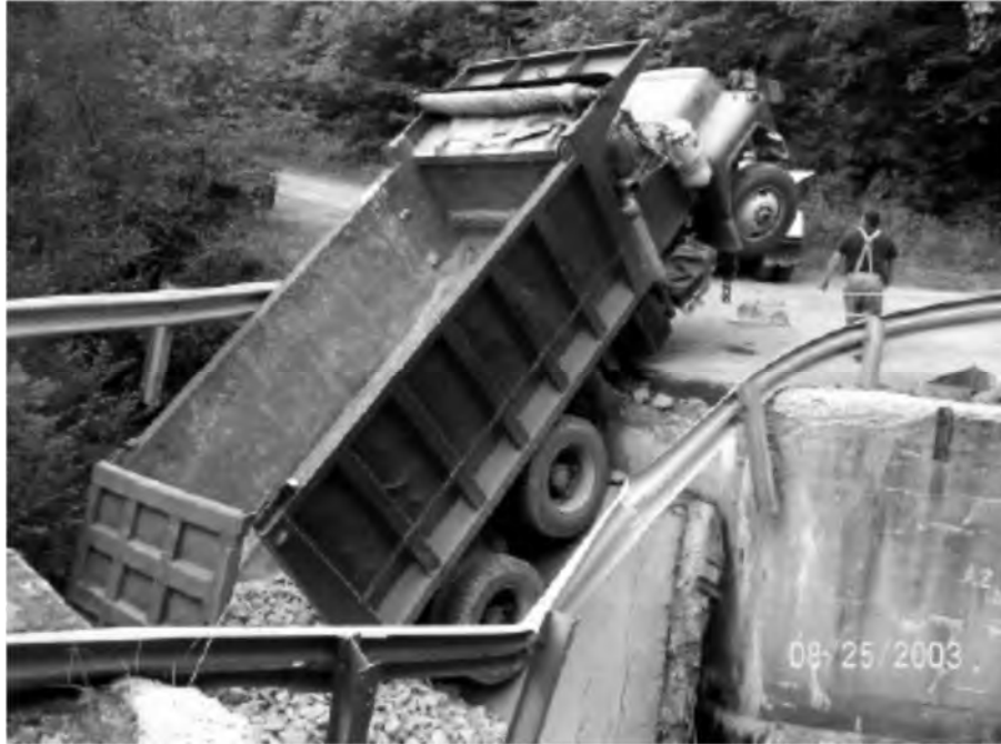
รูปที่ 4-15 แสดงความเสียหายที่เกิดจากการบรรทุกเกินน้ำหนัก
