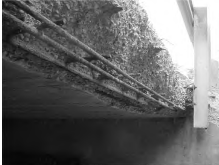
รูปที่ 4-16 การกัดกร่อนของเหล็กเสริม
